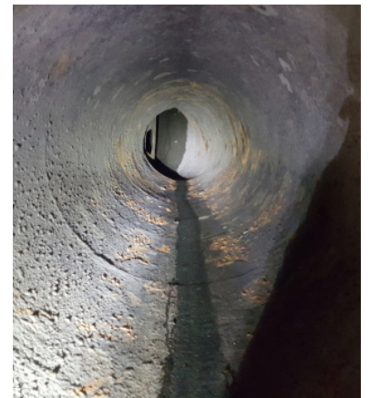
Außenansicht der 45° abgewinkelten Druckrohrleitungen.
