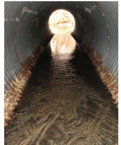
198 cm Metallwellrohr war korrodiert und defekt.
