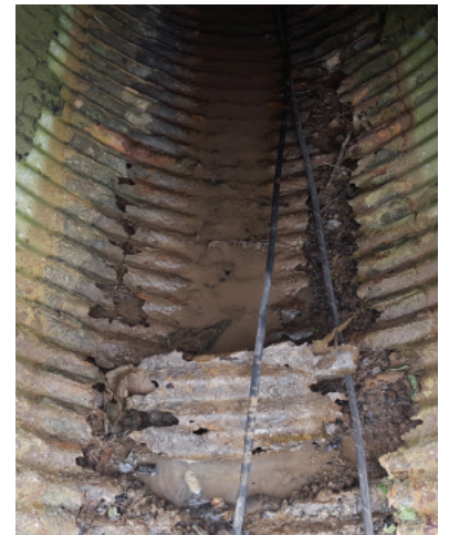
Dieses alte Metallwellrohr-Durchlass war in vielen Bereichen völlig durchkorrodiert.
