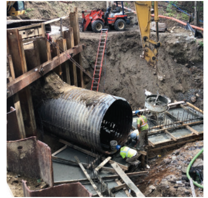
Der Durchlass des NHDOT erforderte eine erhebliche Verstärkung als Teil des gesamten Sanierungsprozesses.
